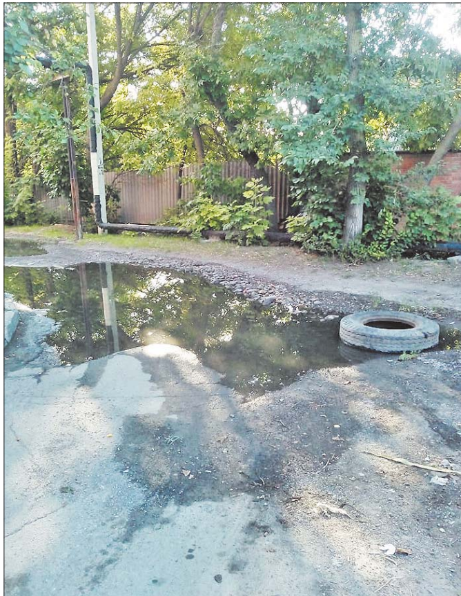
Порывы канализации происходят постоянно и по всему городу.
