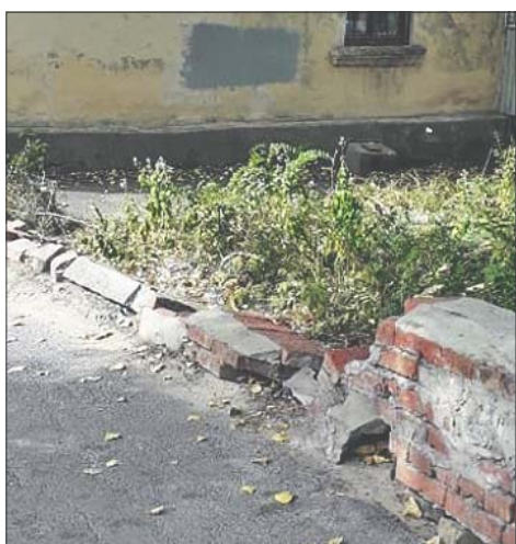
Шахтинка возмущена разрушенным бордюром в центре города.
