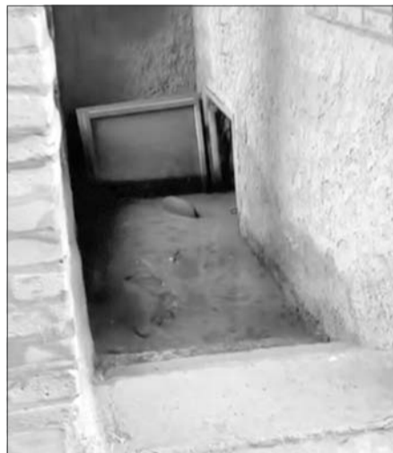
В случае ЧП горожане не смогут укрыться в подвале, так как он забит канализацией.
