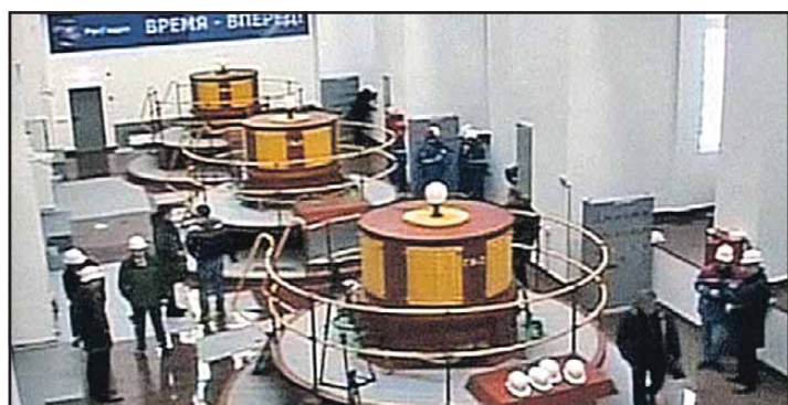
Баксанская ГЭС - самая современная на Северном Кавказе. Все оборудование здесь - отечественного производства.
