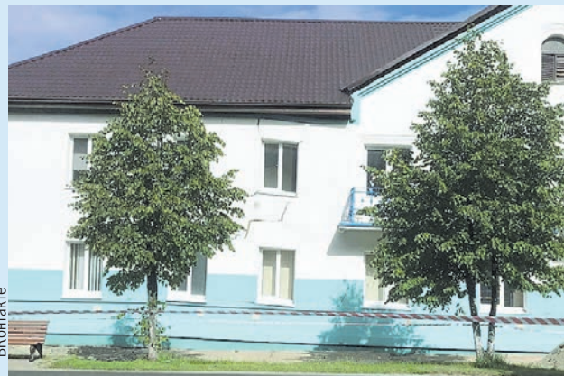
По стене пошли трещины, жить здесь стало опасно...
