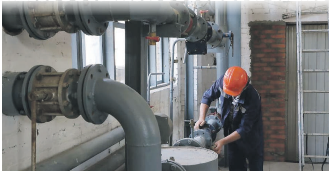
На котельных ведут проверку.
