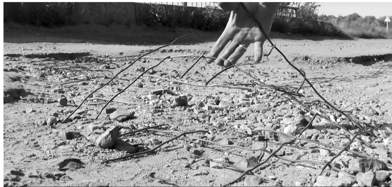
Девять лет назад здесь отремонтировали одну полосу, причем капитально. Но того ремонта - уж и след простыл.
