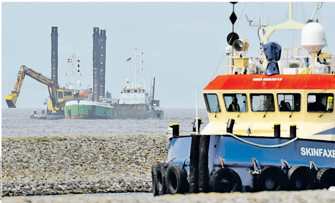
Пока получают разрешения на прокладку «Северного потока-2» (осталась только Дания), в районе немецкого Грайфсвальда уже идут работы по расчистке «фарватера» для будущего газопровода.
