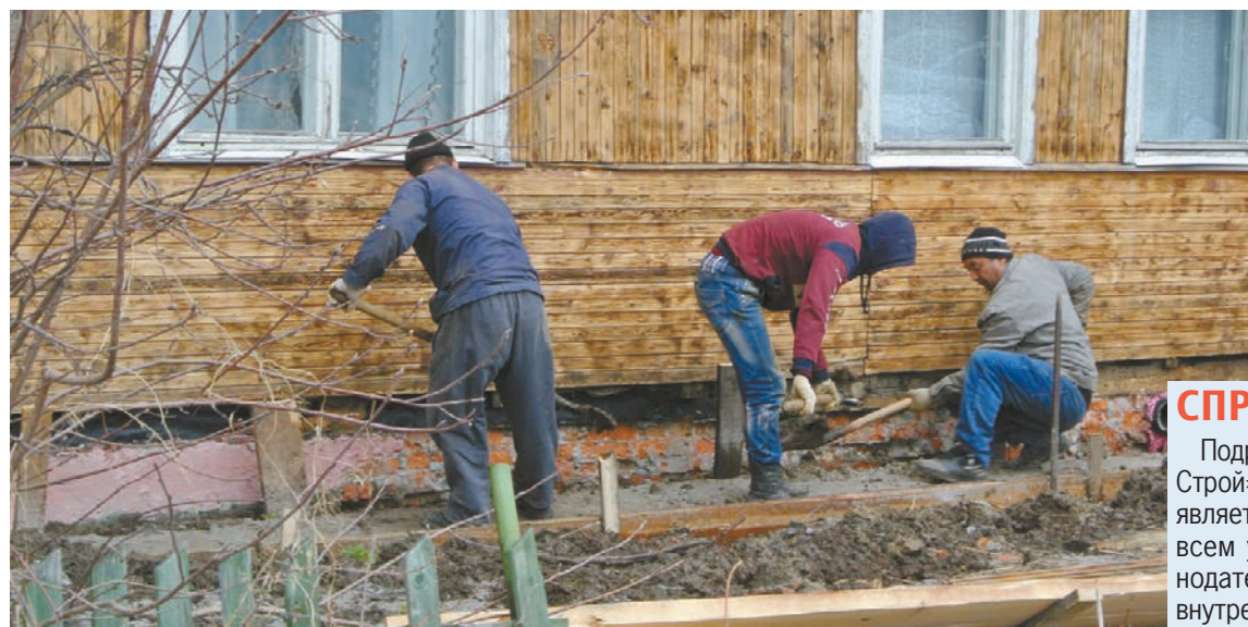
Замена труб может окончательно разрушить и без того трухлявые стены дома, уверены жильцы.
