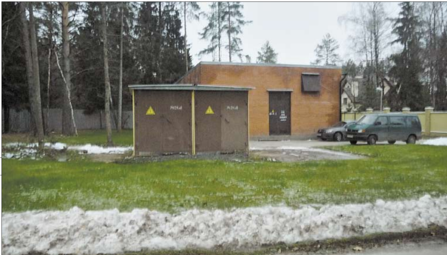
Подстанция, построенная Шандаловым для энергоснабжения своего дома на средства ООО «Скат»
