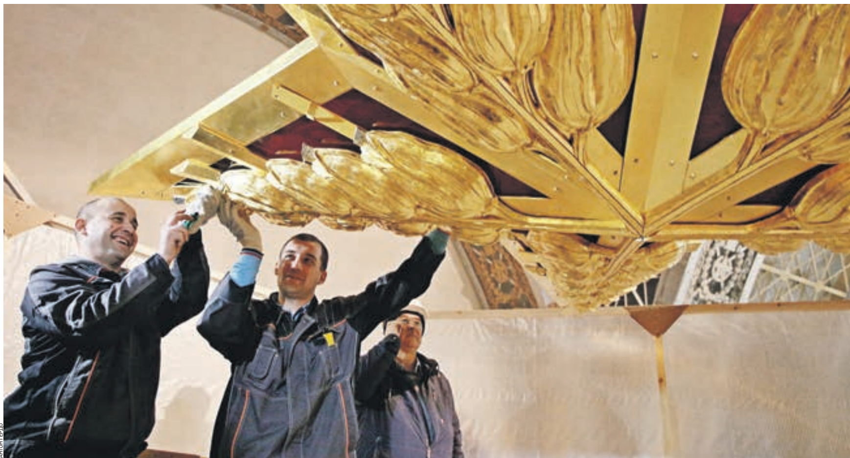
17 ноября 17:00 Рабочие Дмитрий Воронков (слева) и Александр Козуб завершают монтаж декоративных элементов к «звездной» люстре. За процессом наблюдает автор этого проекта Валерий Новгородцев
