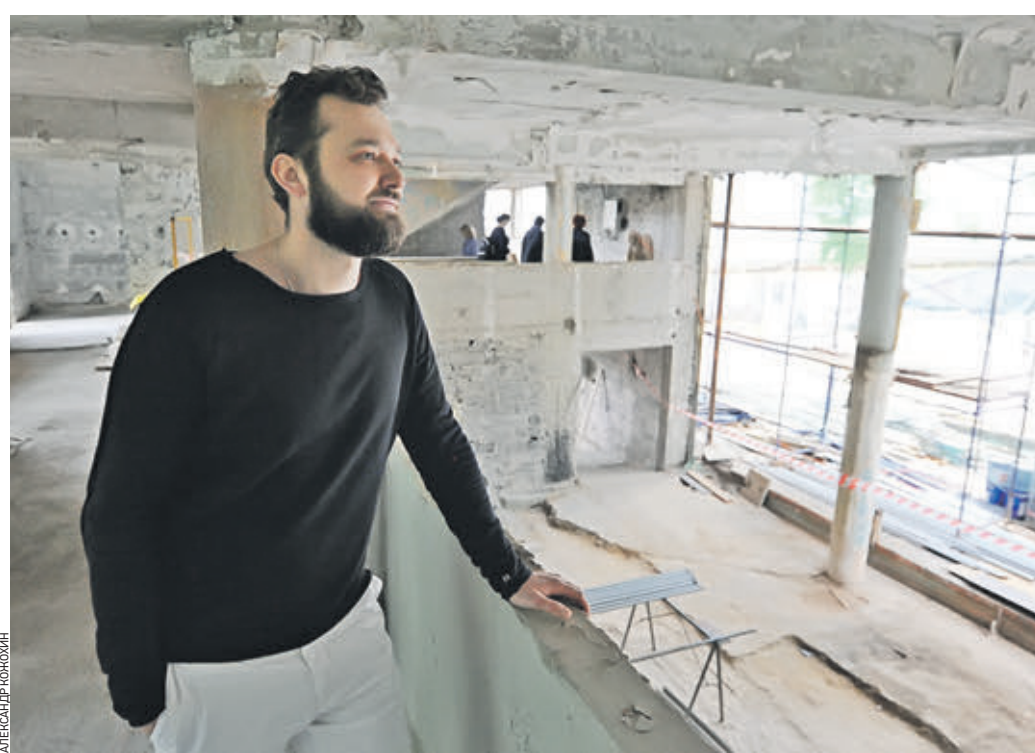
Вчера 11:48 Бывший житель дома Наркомфина Ярослав Рязанский осматривает ход реставрации этого памятника архитектуры
