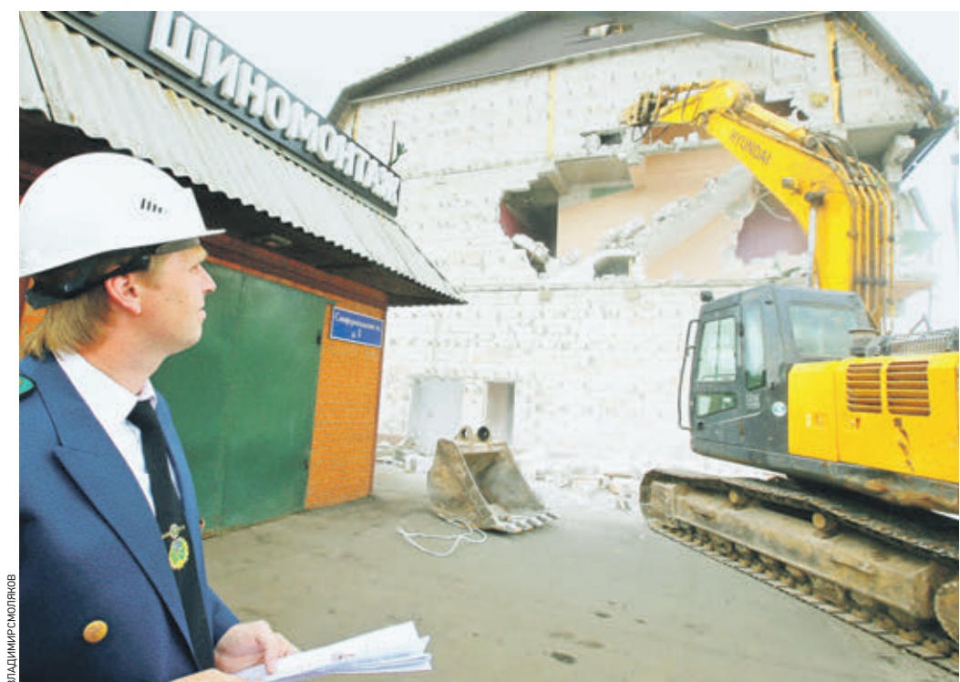
Вчера 12:41 Главный инспектор Госинспекции по недвижимости Сергей Шипилов контролирует демонтаж незаконной трехэтажной гостиницы в городском округе Щербинка
