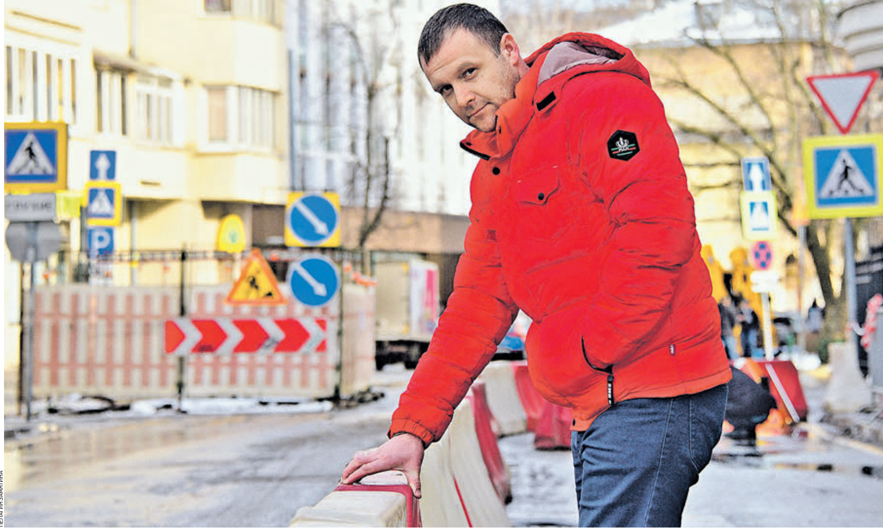
Вчера 15:22 Начальник участка благоустройства компании, которая проводит работы в Даевом переулке, Михаил Глазунов следит за ходом обновления. Сейчас там устанавливают временные ограждения и дорожные знаки, которые ограничивают движение автомобилей и пешеходов
