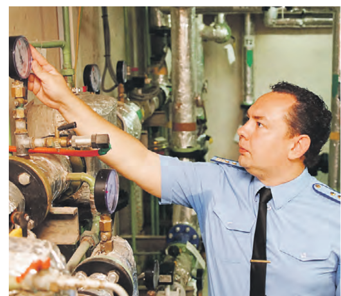
Вчера 09:19 Главный специалист Жилинспекции по CAO Владимир Федоров проверяет работу систем отопления
